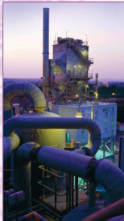
Cogeneración con residuos de madera. La Montañanesa, S.A. (Zaragoza)
