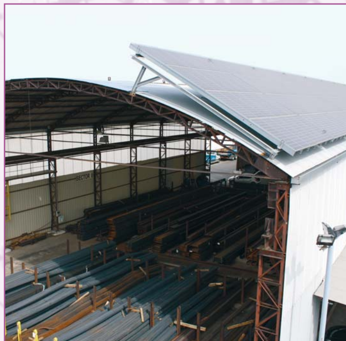
Instalación fotovoltaica conectada a red en cubierta. Hierros Alfonso, S.A. (Zaragoza)
