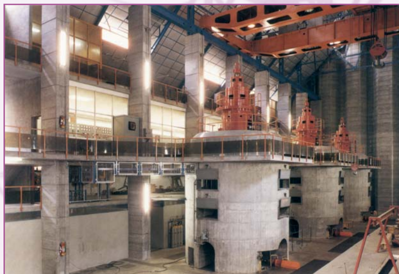
Grupos de potencia de la central hidroeléctrica de Ip de 84 MW
